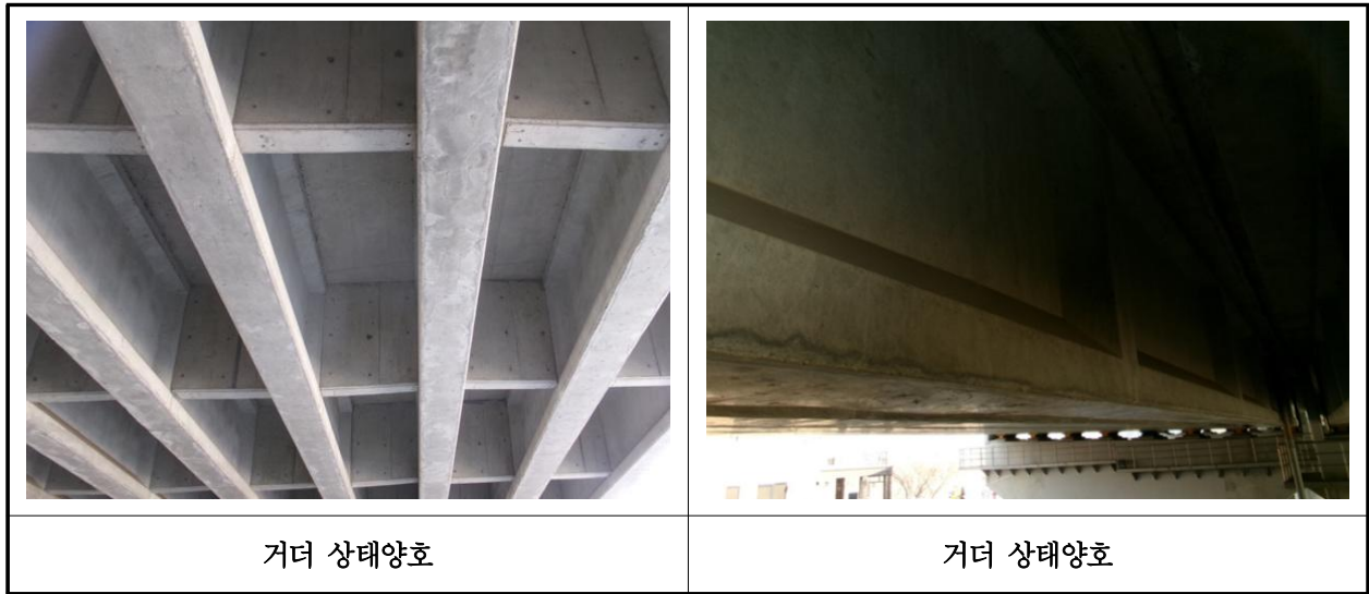
【사진 1.3.5】 거더 손상현황
