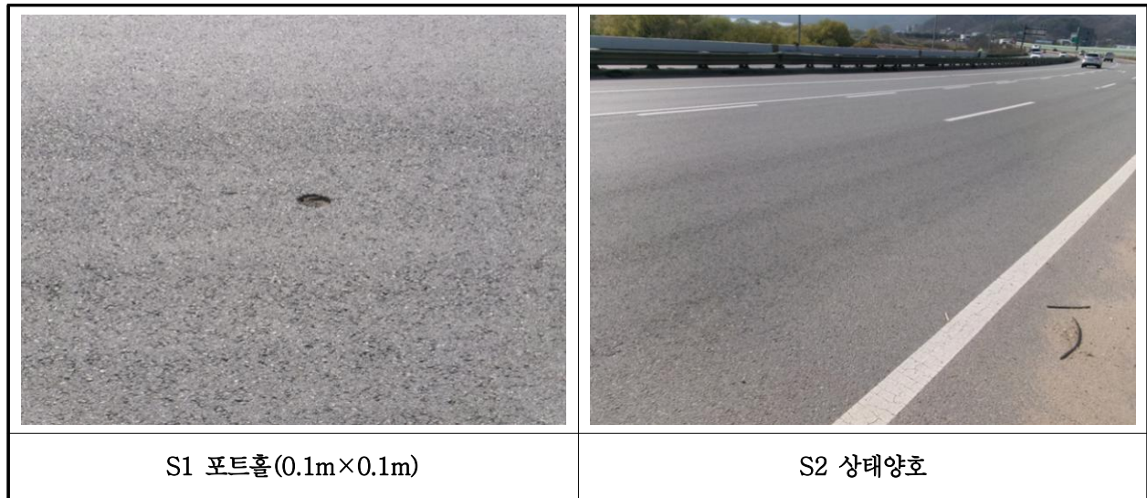
【사진 1.3.20】 교면포장 손상현황
