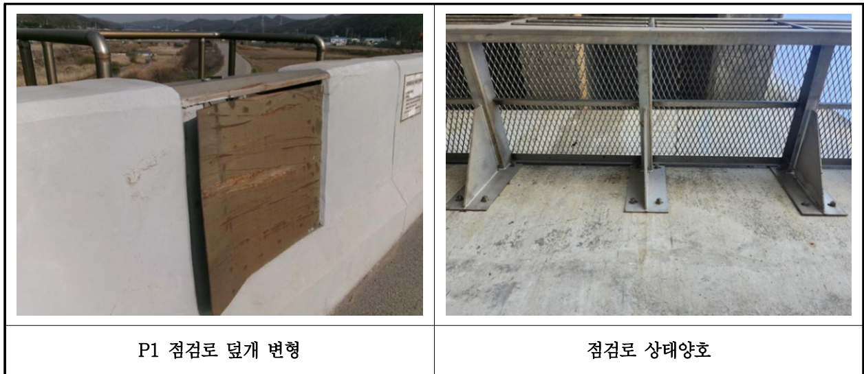
【사진 1.3.26】교량 점검시설 손상현황
